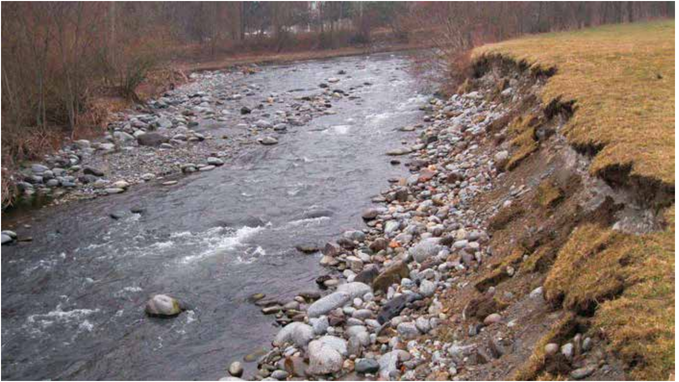
Malonno: argini in erosione in sezioni di deposito del fiume (2013).
